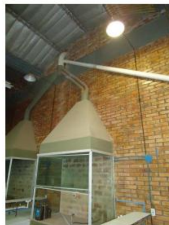
Campana extractora de gases
