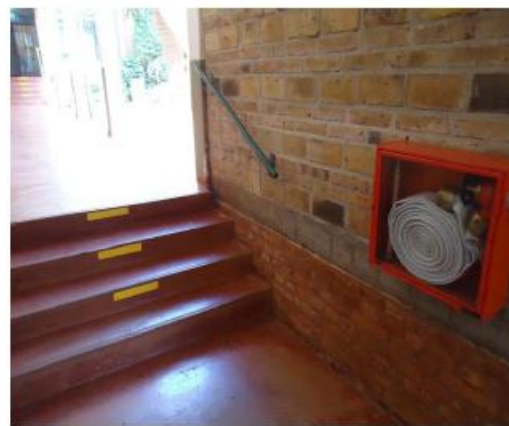
Boca de Incendio Planta Baja
