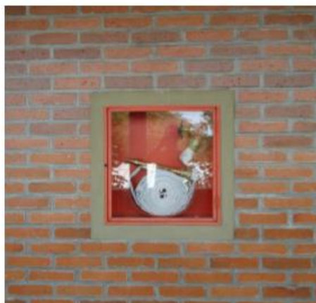
Boca de Incendio 2° Piso
